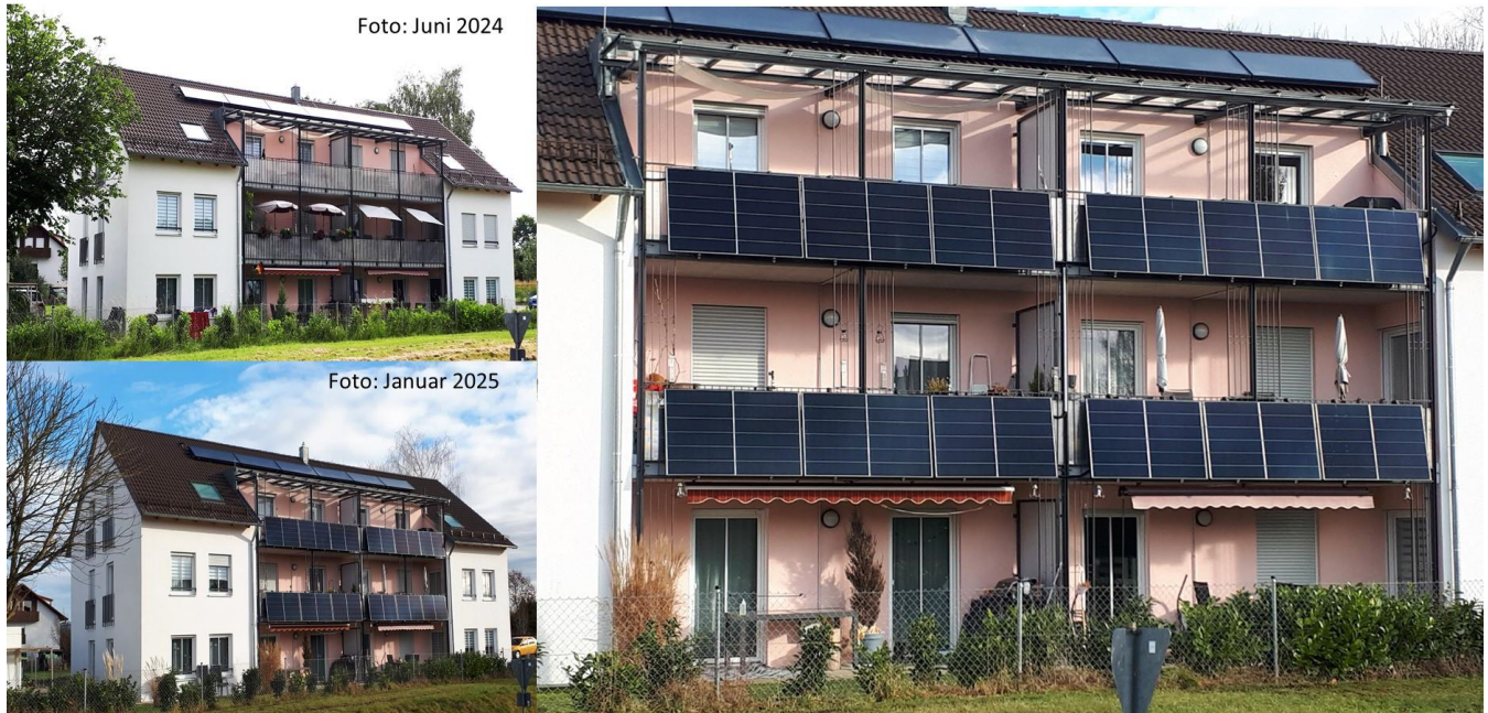
Abbildung 3: Balkon-PV auf Mehrfamilienhaus in der Fraunhoferstraße 2a.
